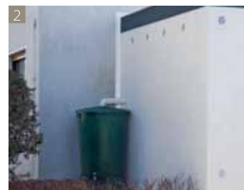
Odvodňovací potrubí je vedeno na obvodovém plášti stěny garáže a ústí do připraveného odtokového systému.
